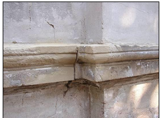
Ansicht der Fassade nach bauseits erfolgter Farbschichtabnahme, Detailaufnahme einer plastischen Ergänzung mit Fugennachbildung. Ergänzung mit Fugennachbildung.
