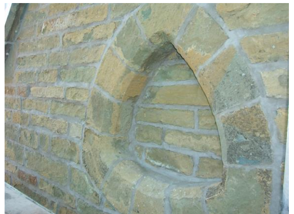
Blindfenster im Giebel nach dem Ausbau des schadhaften Fugennetzes (oben) und im Endzustand.
